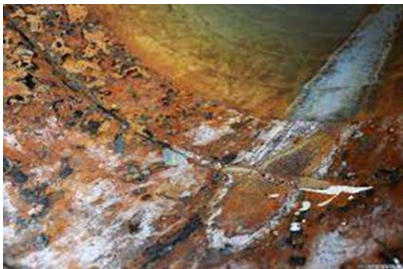
Рисунок 1 – Общая коррозия металла
