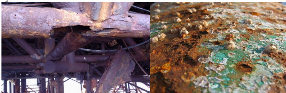
Рис. 1 - Коррозия опор буровой платформы
