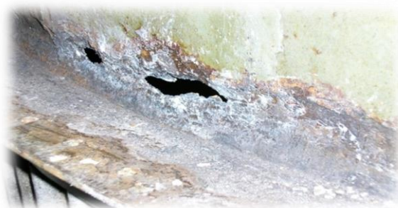
Рис. 2 – Коррозия металла стенки РВС
